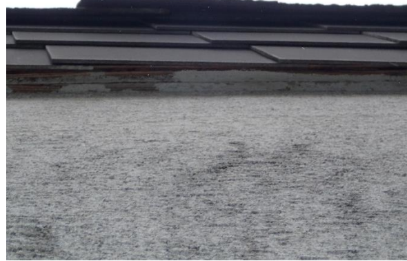
Abbildung 4: Dachspalt des Anbaus
