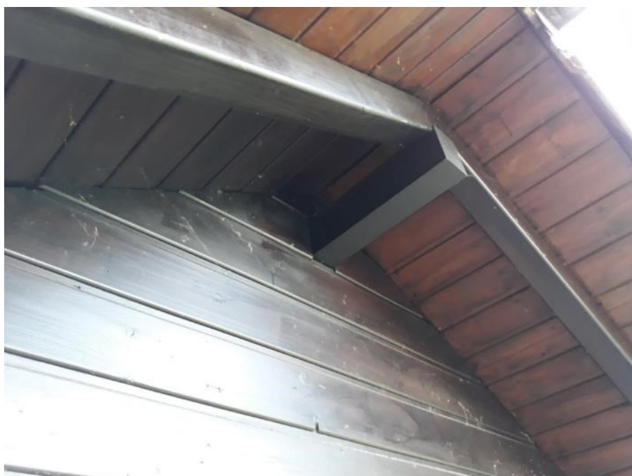
Foto 15: Der Dachbalken des Schuppens bietet Nist- potential für Vögel.
