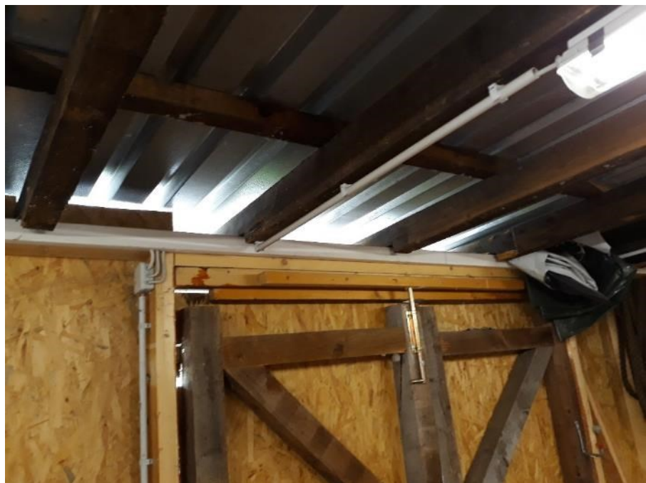
Foto 23: Die Konstruktion ermög- licht Vögeln und Fle- dermäusen ein leichtes Eindringen in den Innen- raum. Der neu erweiter- te Schuppen soll in glei- cher Bauweise errichtet werden.
